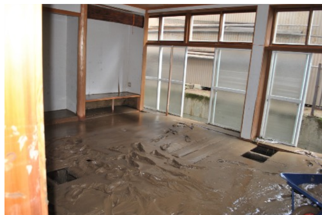
1階が浸水した旅館では、水が引いた後、大量の泥で室内が覆われていました(大江町)
