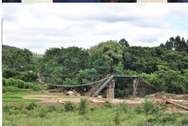
JR米坂線の鉄橋が崩落した現場(飯豊町)
